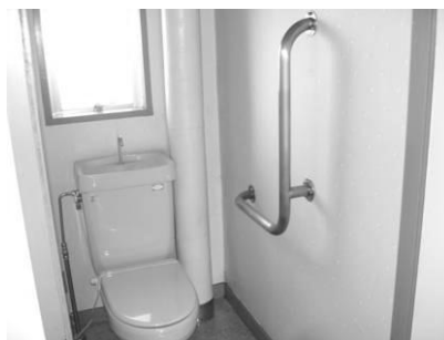
「トイレ」の手すり設置例
