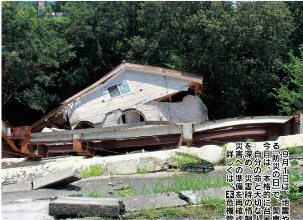
平成28年 熊本地震により倒壊した建物
