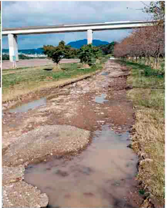
▲冠水した利根川河川敷公園の園路
