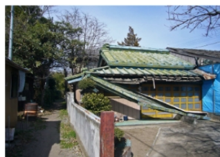
①老朽化した空き家
