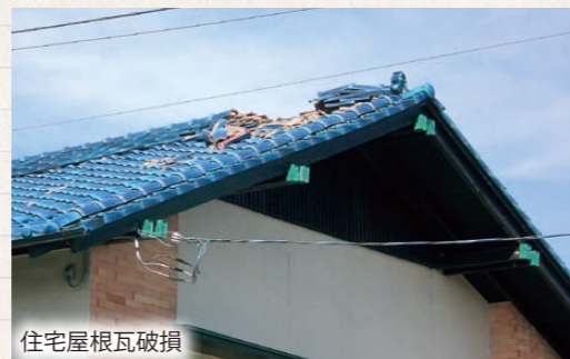
住宅屋根瓦破損
