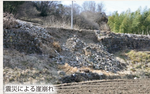
震災による崖崩れ
