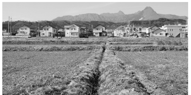
改良工事が望まれる水路
