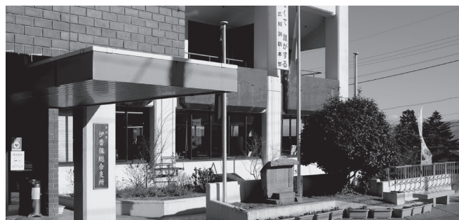
深刻な施設の老朽化（伊香保総合支所）
