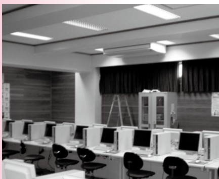
特別教室に設置されている エアコン
