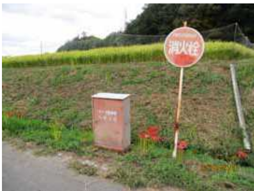
消火栓の案内標識とホース格納箱
