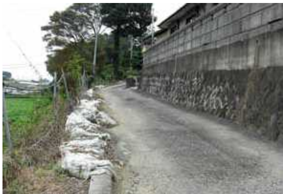
修復が待たれる豪雨被害の道路
