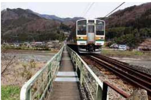
平成22年度予備設計以来、進ちよくの ない小野子祖母島間橋りょう
