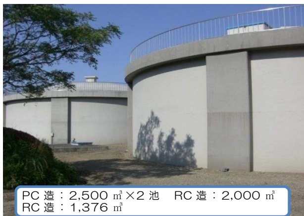
1 渋川低区配水場
