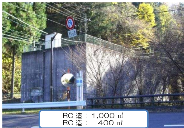
3 西沢第3配水池
