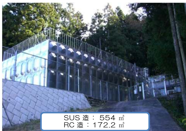
6 小池原配水池
