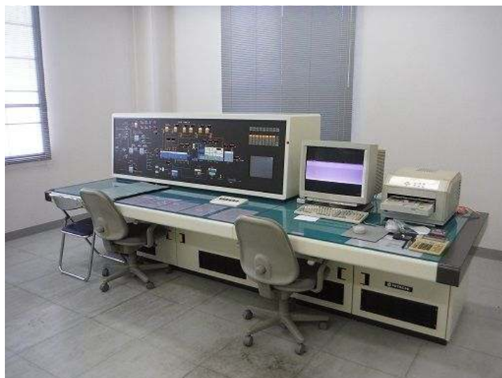
長峰浄水場の集中監視・制御システム
