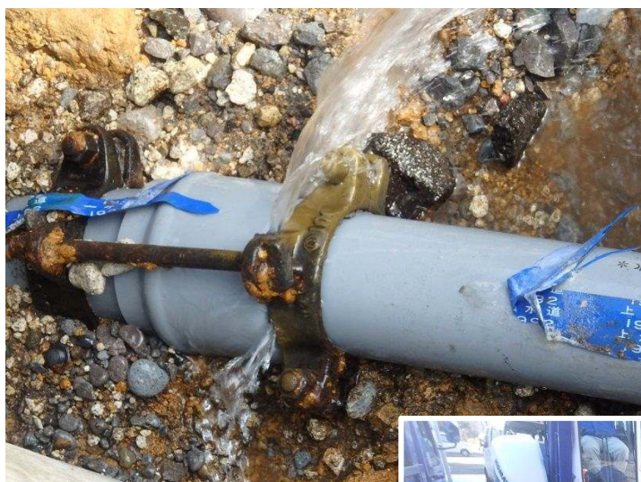
老朽管の漏水
