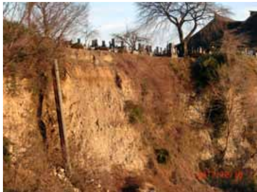
崖崩落により排水管露出
