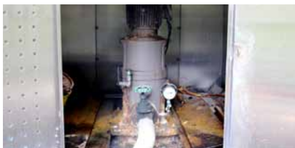
黄金の湯 湯湯ポンプ
