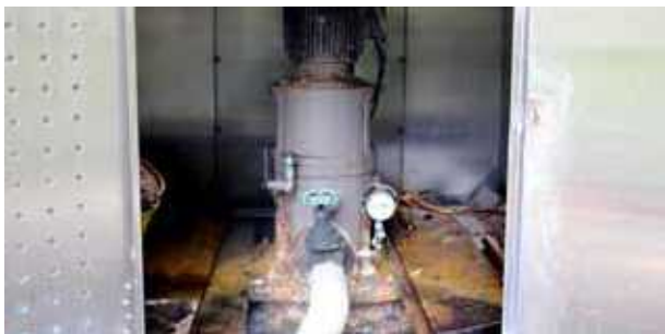
黄金の湯 揚湯ポンプ
