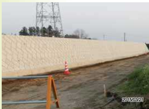
基礎が露出している北橋運動場の擁壁
