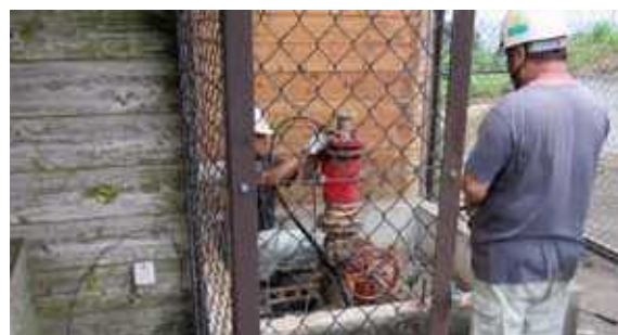
交換された揚湯ポンプ
