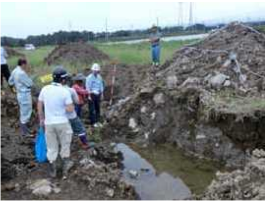
投棄された土砂を調査する職員
