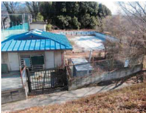
早急の渋川北中学校のプール解体及び周辺整備
