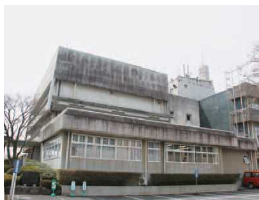
大規模災害で倒壊の恐れのある本庁舎
