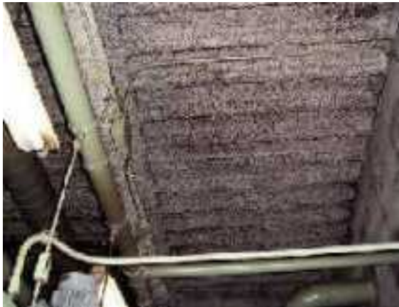
石綿含有吹付けロックウール
