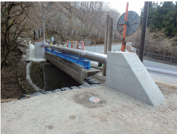
伊香保地区水管橋
