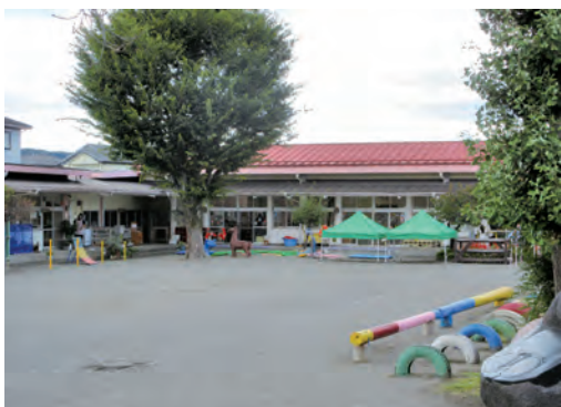
二階の高まる公立保育所 老朽化が心配される第四保育所
