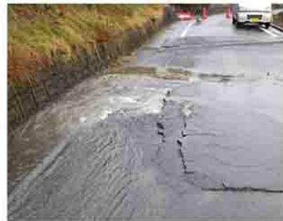
道路からの漏水
