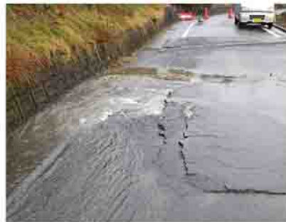
道路からの漏水
