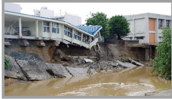
河岸侵食による被害 [出典／九州地方整備局資料]
