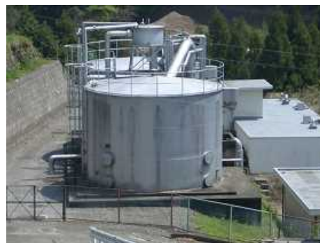
入沢浄水場(新幹線立坑水)
