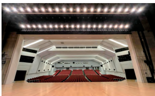
渋川市民会館大ホール舞台照明設備
