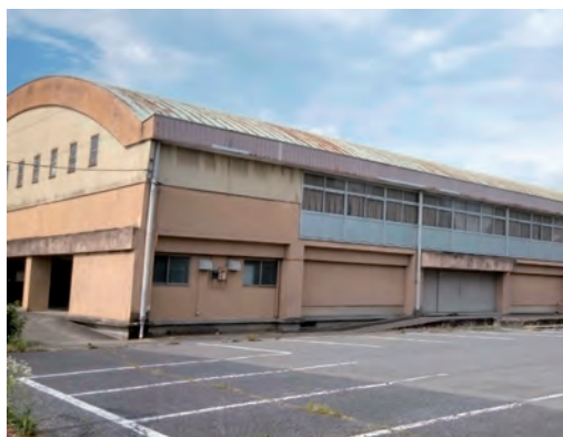
老朽化が著しい市民体育館
