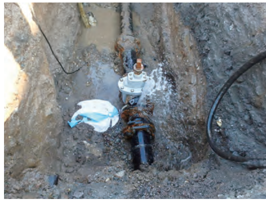
水道管の老朽化による漏水
