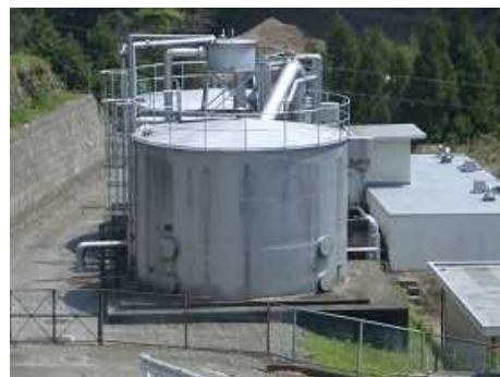
入沢浄水場(新幹線立坑水)
