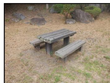
〈劣化が進む休養施設の例〉 天板が腐朽している 木製のテーブル・ベンチ
