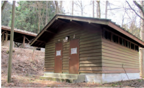
解体せず残すことなどが望まれる旧赤城キャンプ場のトイレ
