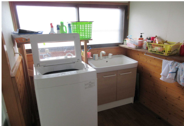
洗濯機置き場、洗面所
